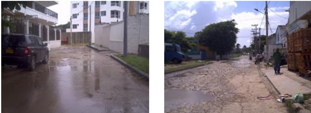
Foto 2-4. Estado de las vías a rehabilitar
